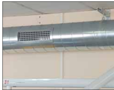
Εικόνα 2: Αεραγωγός μεγάλης διατομής για την ανανέωση του εσωτερικού αέρα.
