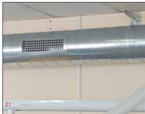
Εικόνα 2: Αεραγωγός μεγάλης διατομής για την ανάνεωση του εσωτερικού αέρα.
