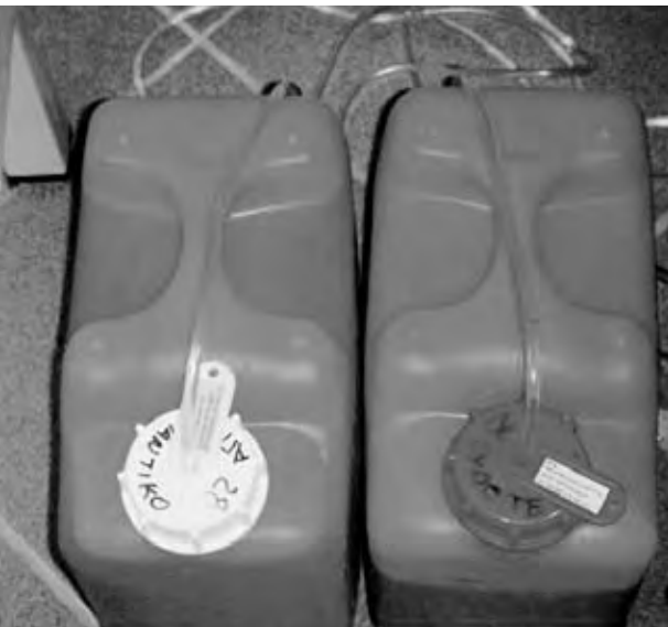
Εικ. 3: Σύστημα αυτόματης τροφοδοσίας του πλυντηρίου με απορρυπαντικό και αποσκληρυντικό διάλυμα.
